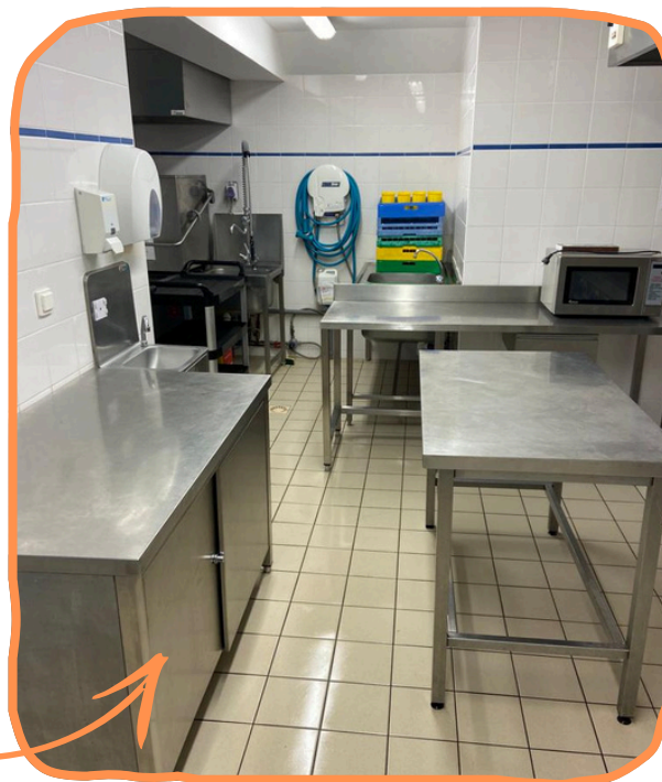
Cuisine professionnelle (four de réchauffage, grands frigos, congélateur...)
