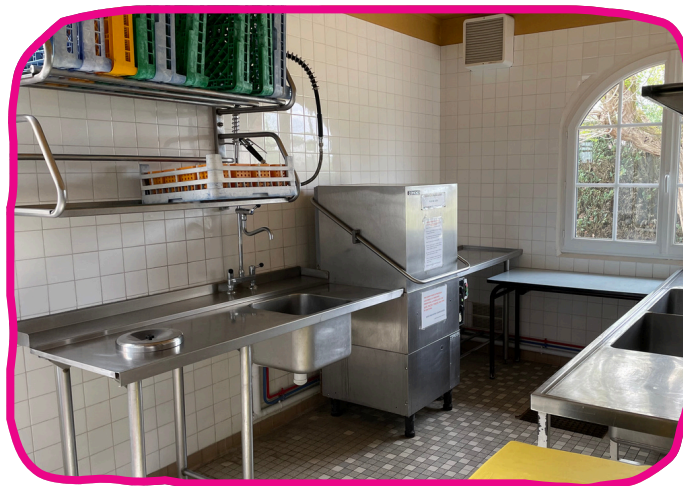
1 cuisine professionnelle équipée (four de réchauffage, chambre froide, frigo, congélateur...)
